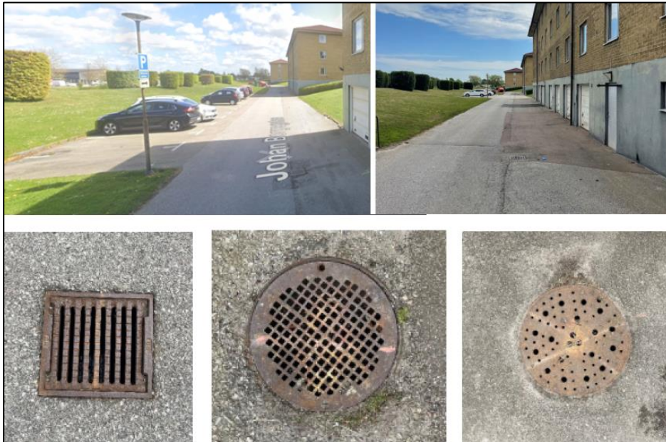
Figur 3-4: Identifierade brunnar för avvattning av gator inom fastigheterna. Foto: NIRAS och Google maps (vänstra fotot, övre raden).
