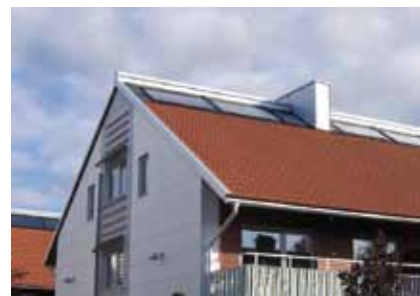
Solfångare i takfallet.
